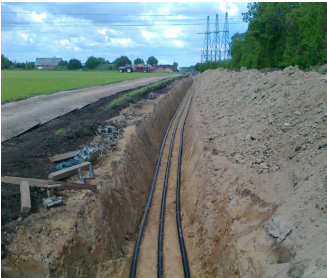
Figur 3-8. Kabelanlæg i åben grav.
